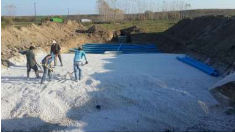
Nadırlı Köyü Foseptik ve Doğal Arıtma Tesisi
